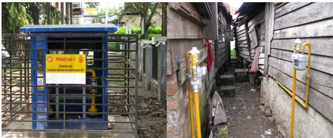
Gambar I-14 Instalasi Jaringan Gas Kota
