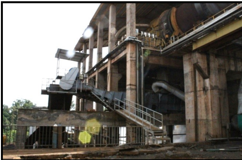
Gambar 3.22. Fasilitas Pengolahan dan Pemurnian PT Sebuku Iron Lateritic Ores (2)
